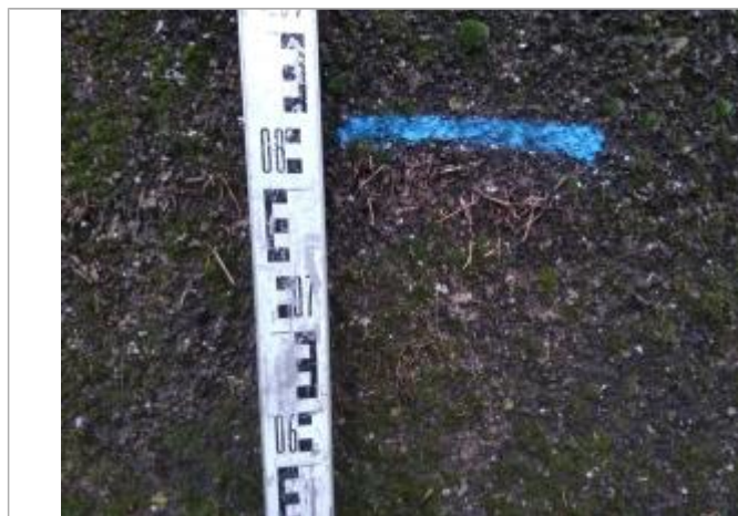
Trace sur le mur
