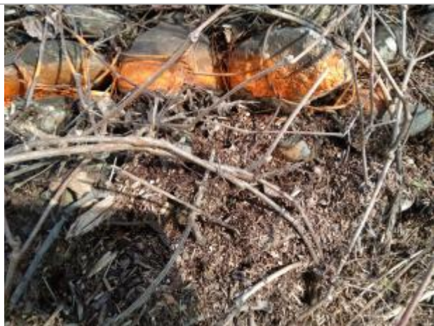
Trace dans les gabions
