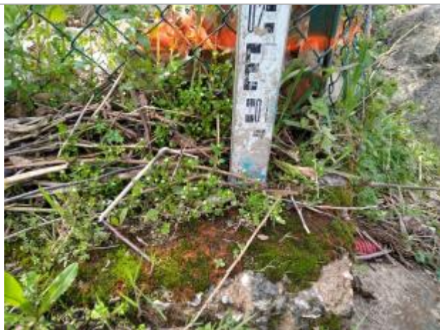
Débris végétaux dans la clôture
