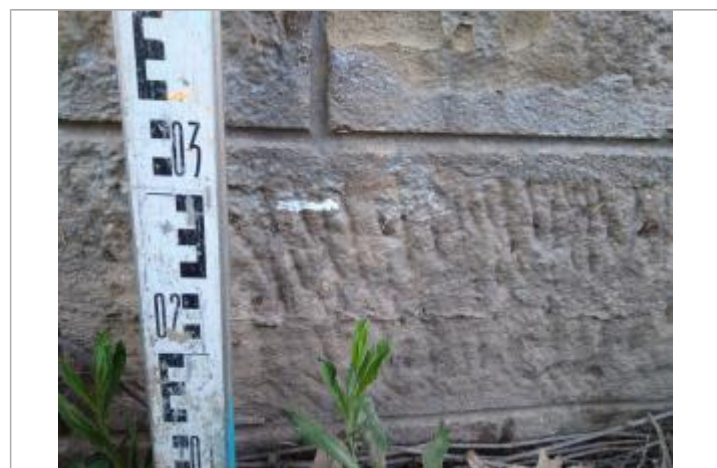
Trace sur la culée
