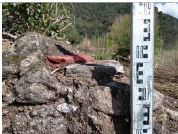
Trace sur le mur
