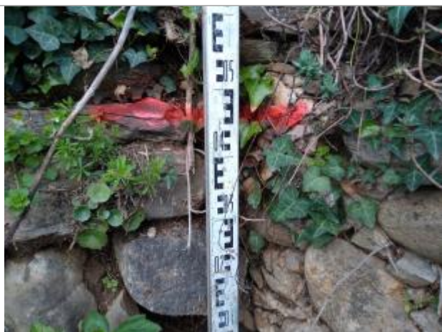
Trace dans l'angle du mur
