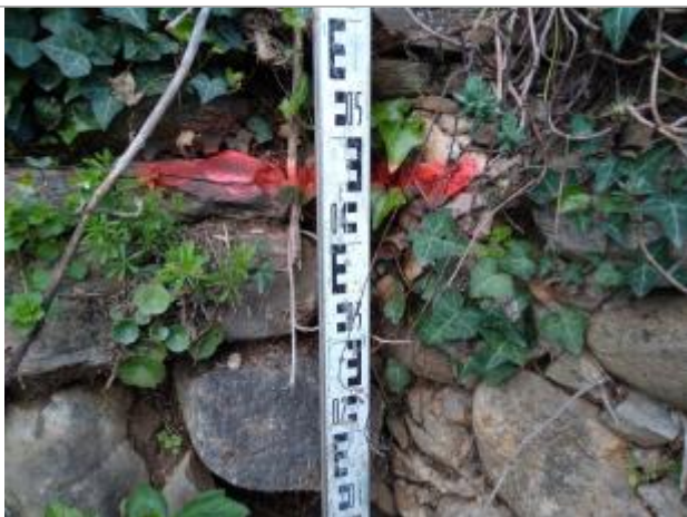
Trace dans l'angle du mur
