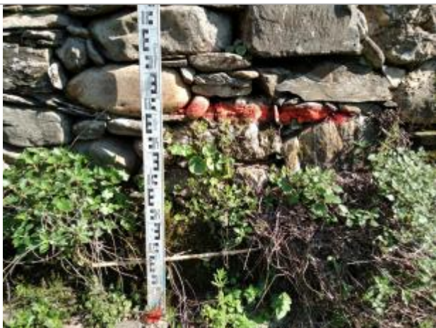
Trace sur le mur
