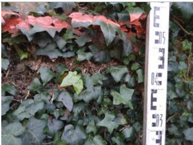
Trace sur le mur en pierre du chemin
