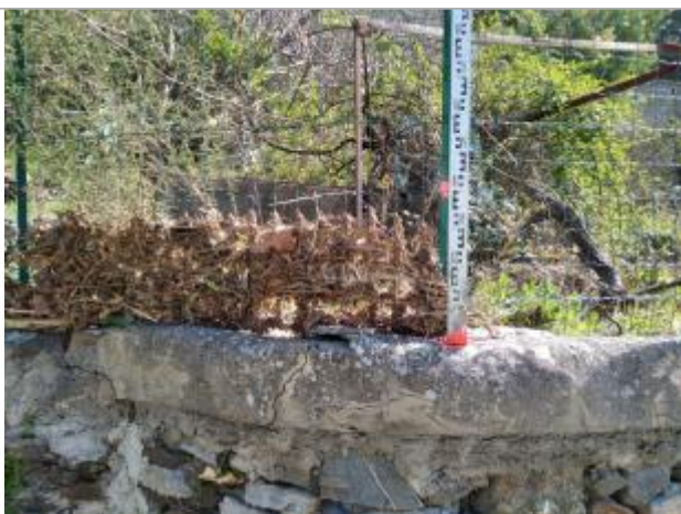
Débris végétaux dans le grillage
