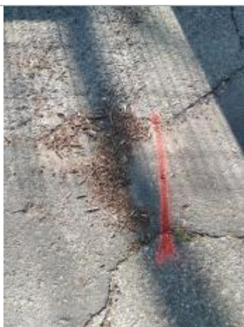
Dépôt sur la chaussée
