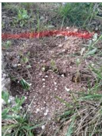
Dépôt dans le fossé
