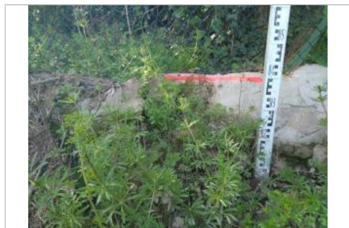
Dépôt contre la clôture
