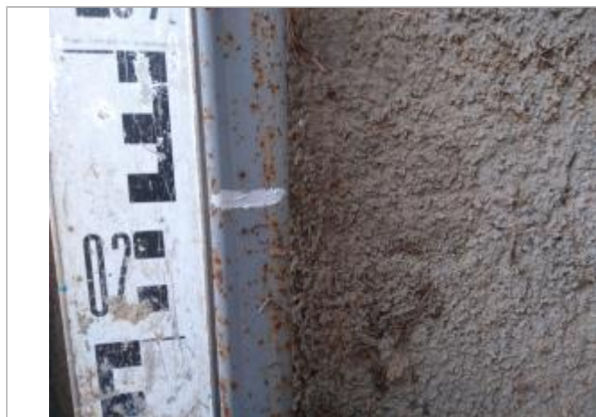
Trace dans l'ouvrage
