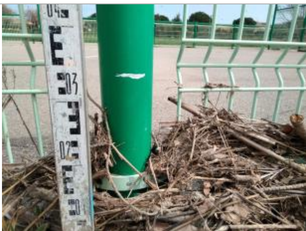
Débris végétaux accrochés au grillage
