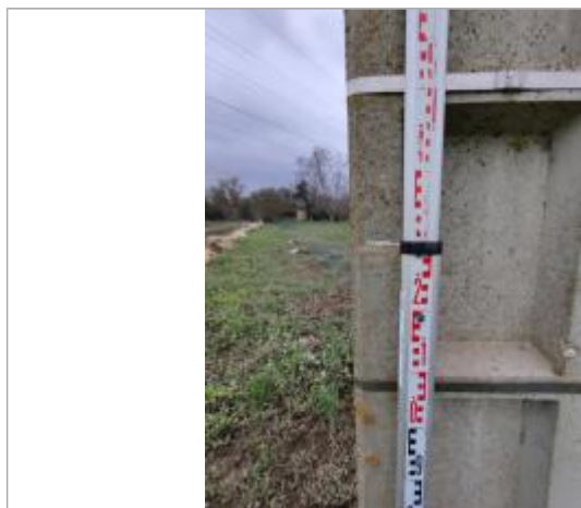
Trace sur le pylône
