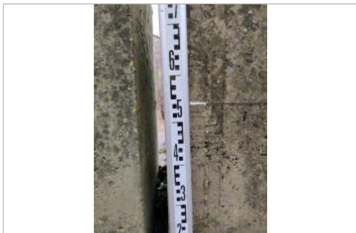
Trace sur le mur
