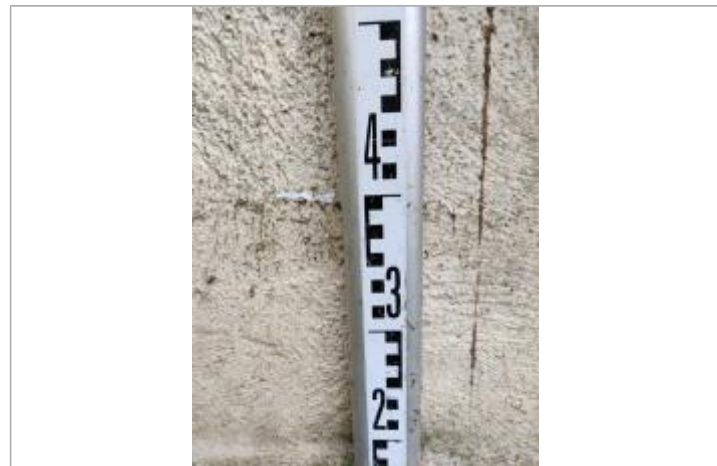
Trace sur le mur
