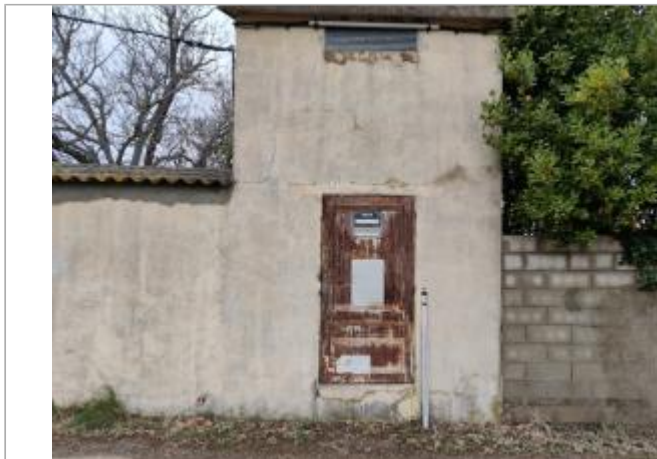
Ancien poste électrique
