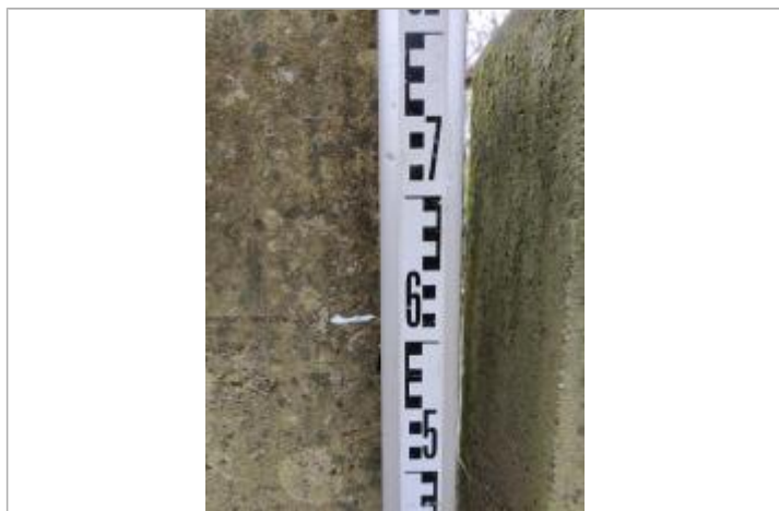
Trace sur le mur
