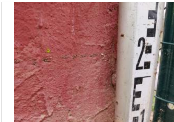
Trace sur le mur
