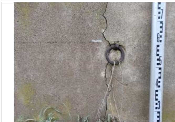
Trace sur le bâtiment
