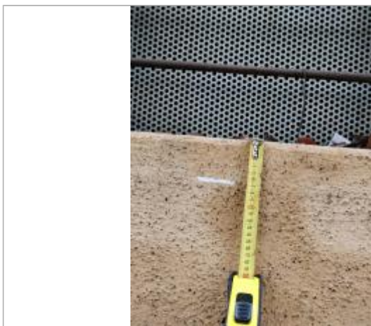
Trace sur le mur
