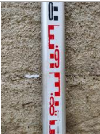
Trace sur la culée
