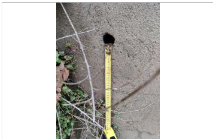
Trace sur le mur
