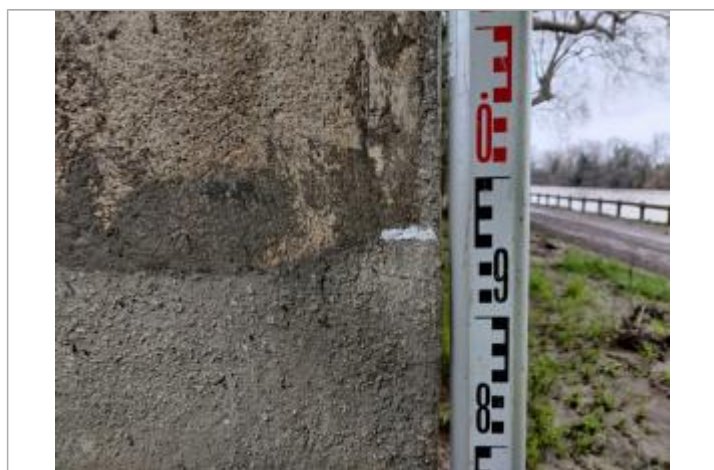
Trace sur le mur
