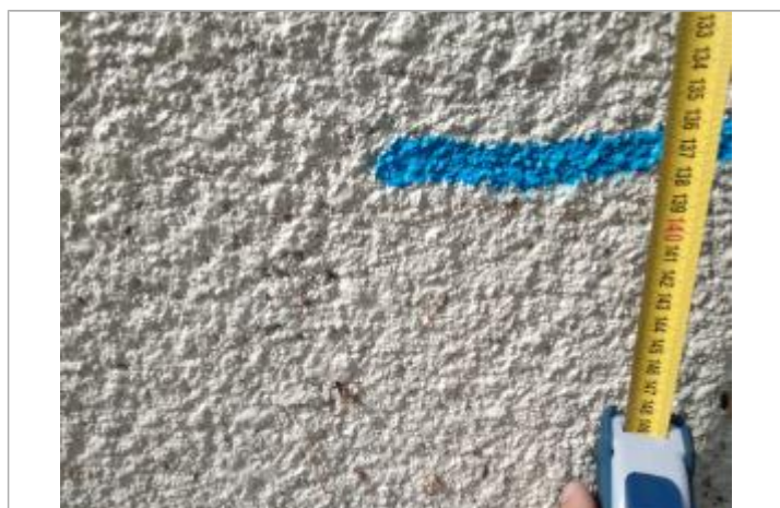
Trace sur le mur
