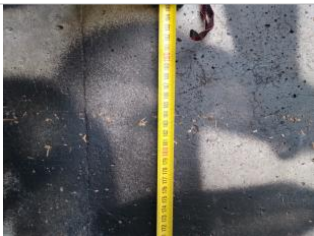
Trace sur le sous-poutre
