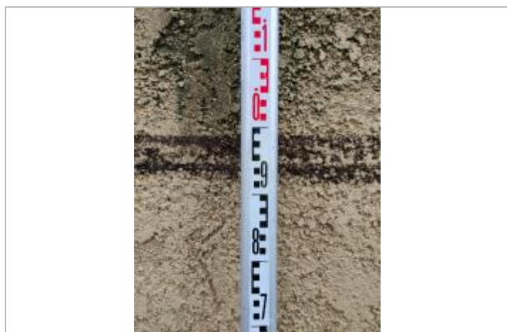
Trace sur le mur
