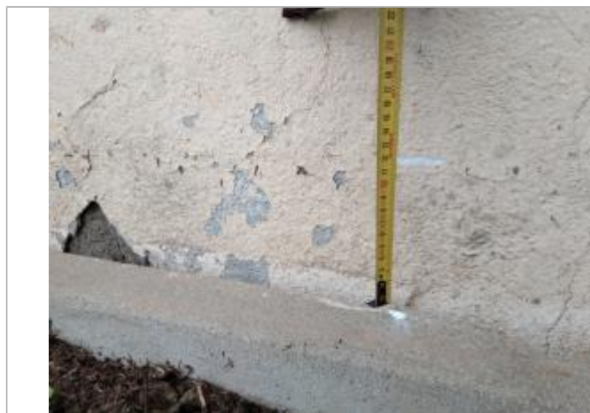
Trace sur le mur
