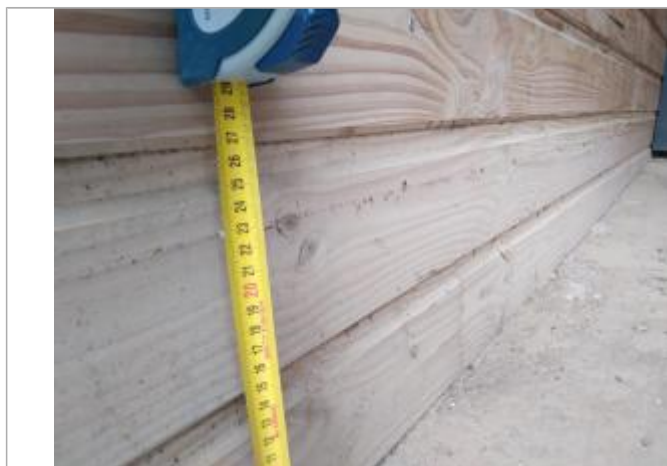
Trace sur le mur
