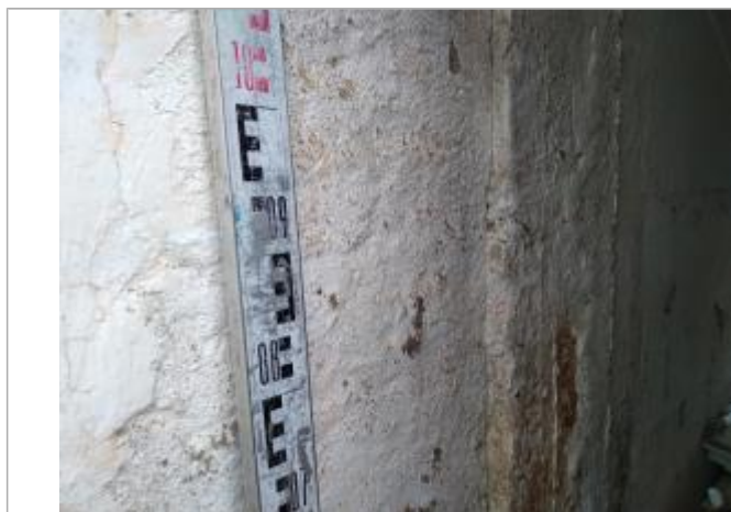
Trace sur le mur
