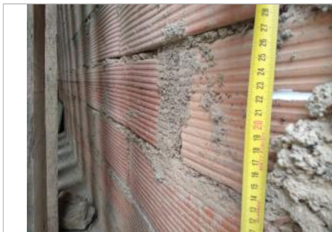
Trace sur le mur
