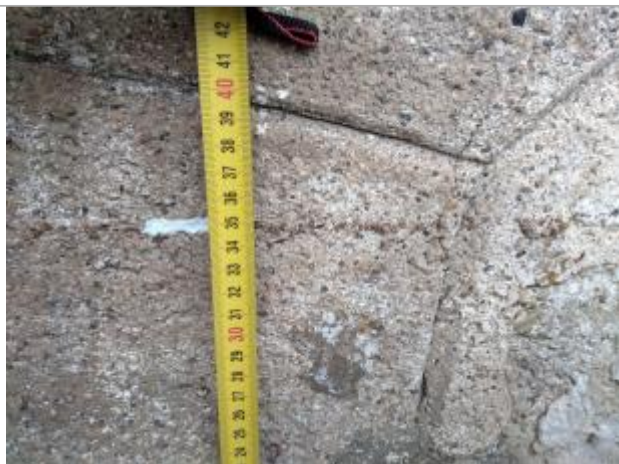
Trace sur le mur
