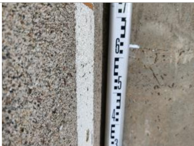
Trace sur le mur
