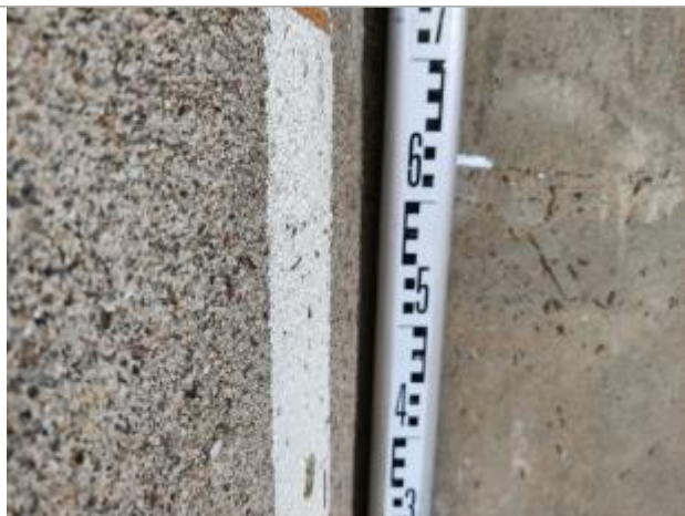
Trace sur le mur
