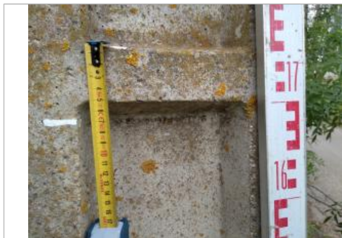
Trace sur le pylône
