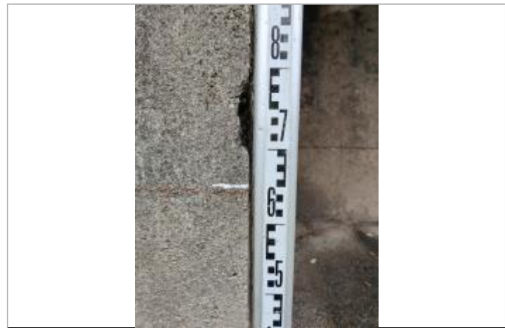
Trace sur les escaliers
