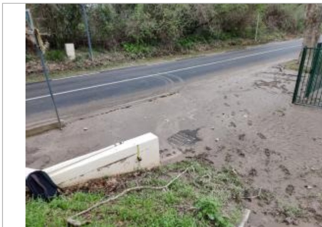
Muret du transformateur
