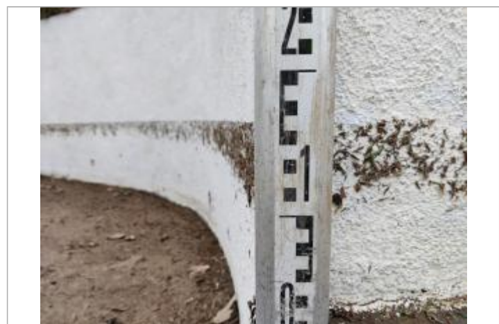
Trace sur le mur
