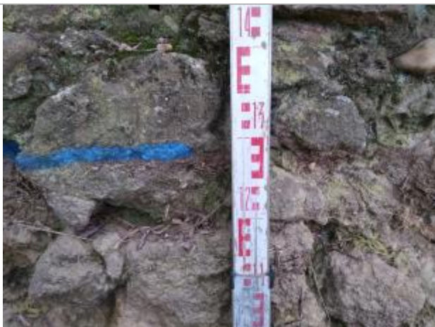
Trace sur le mur
