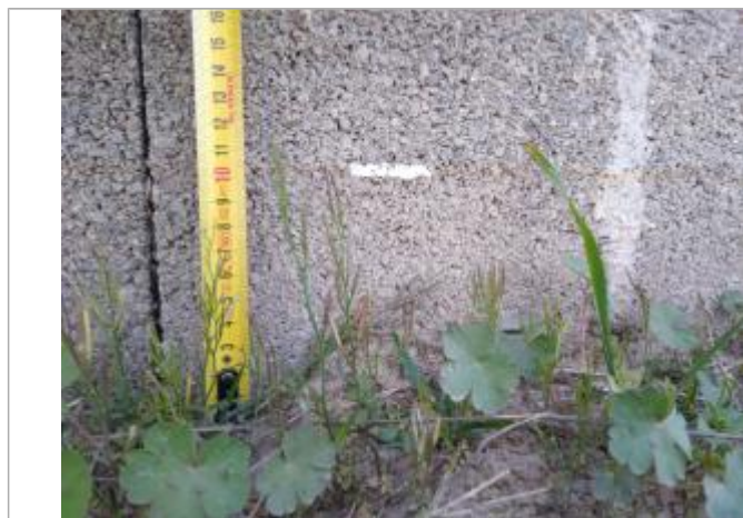
Trace sur le mur
