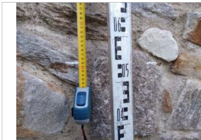
Trace sur le parapet
