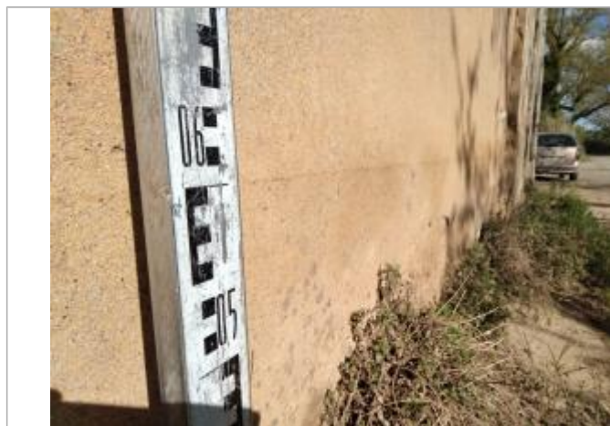
Trace sur le mur
