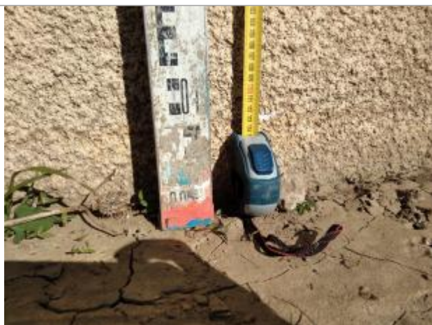
Trace sur le mur
