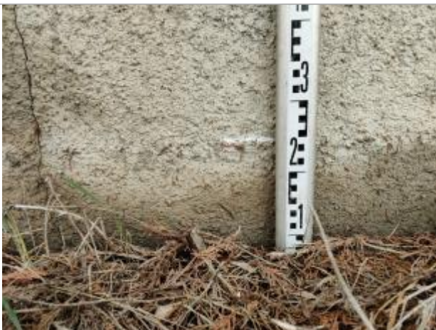
Trace sur le mur
