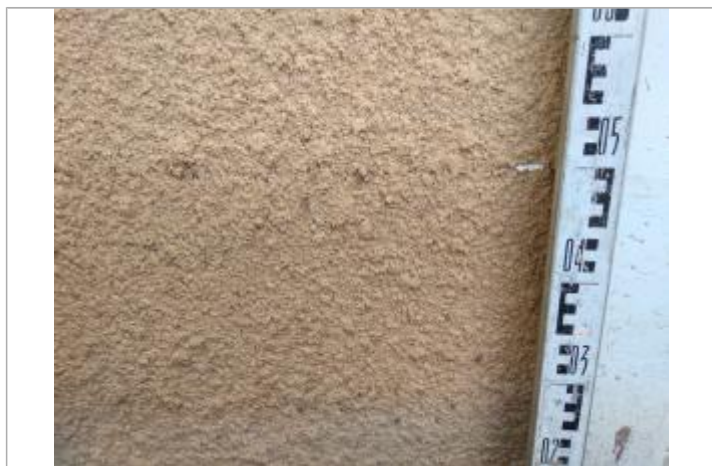
Trace sur le mur
