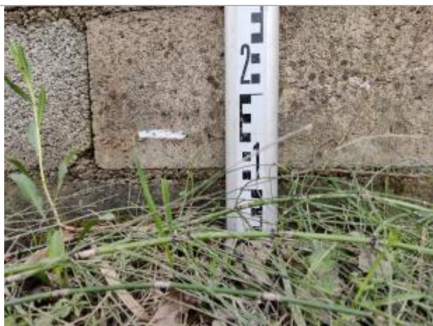
Trace sur le mur
