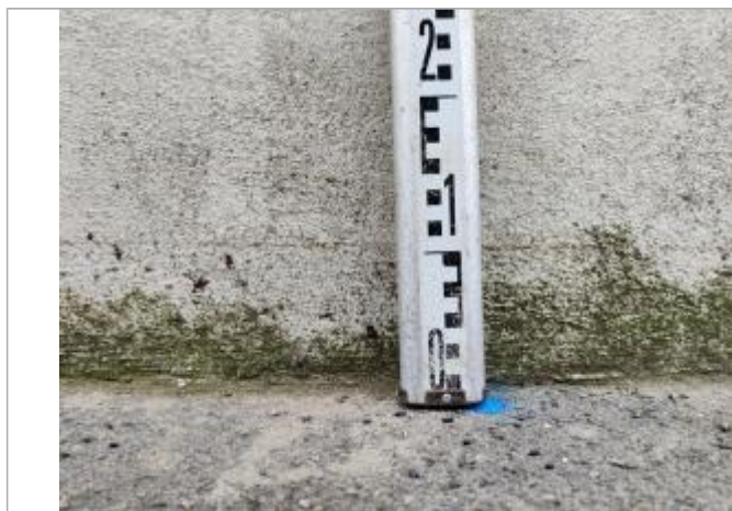
Trace sur le mur
