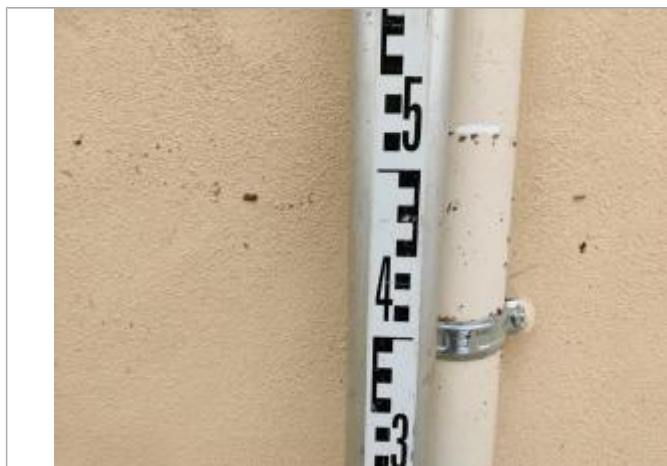
Trace sur la gouttière
