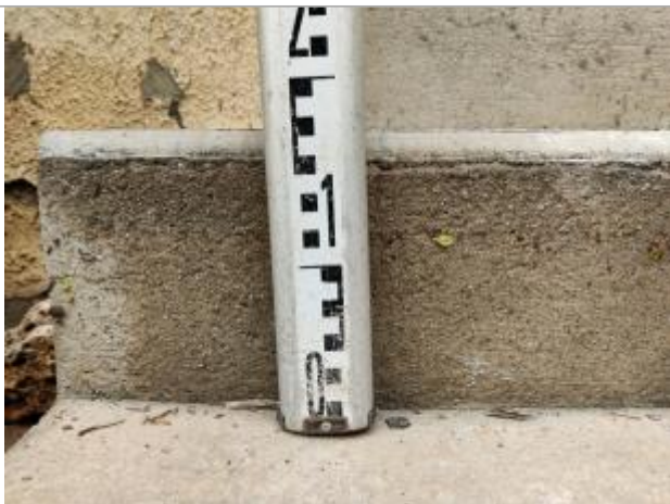
Trace sur les escaliers
