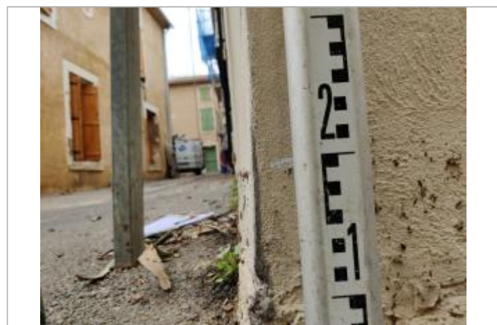
Trace sur le mur
